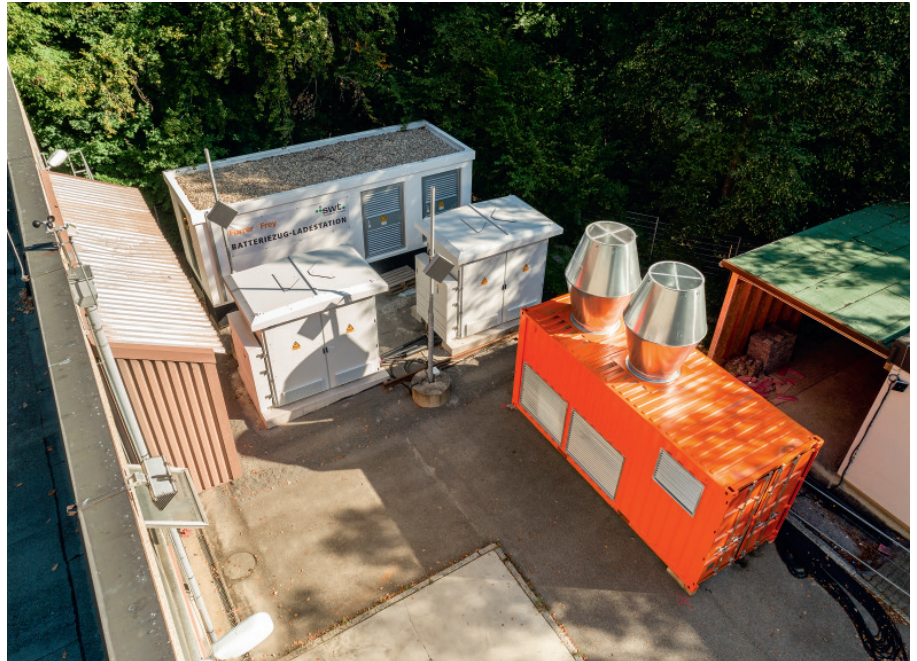
4: Die Teststation abseits der Gleise stand am Fernheizkraftwerk der Stadtwerke Tübingen
