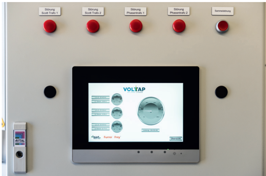
2: Auf dem Display in der Trafostation, die Teil von VOLTAP ist, können die aktuellen technischen Parameter abgelesen werden
