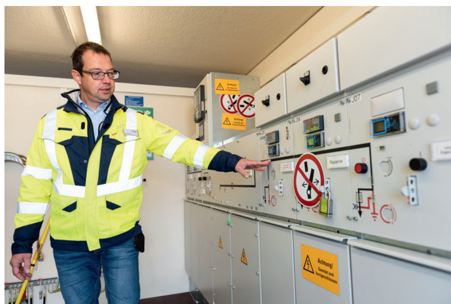
3: Michael Ludolf, VOLTAP-Projektleiter bei den Stadtwerken Tübingen, erläutert die technischen Steuerungseinheiten im Inneren der VOLTAP-Ladestation
