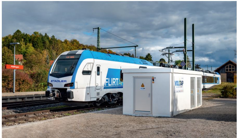
1: Prototyp der VOLTAP-Schnellladestation für Batteriezüge am Test-Gleis in Ammerbuch-Pfäffingen. Testzug von Stadler Rail. Die Schnellladestation besteht aus der Trafostation (Vordergrund) und einer Oberleitungsanlage (OLA) mit Lademasten und Ladeschiene Alle Bilder: swt/Marquardt
